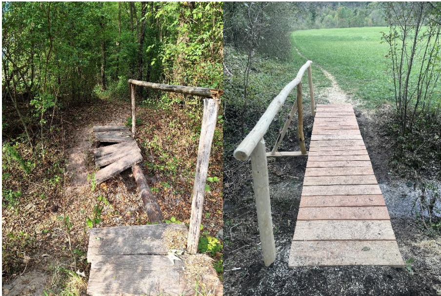
Slika 1: poškodovan mostiček Slika 2: prenovljen mostiček
